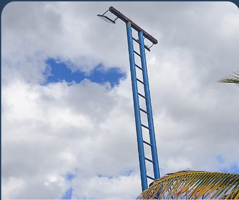
ILUMINAÇÃO LED DE ALTA EFICIÊNCIA
